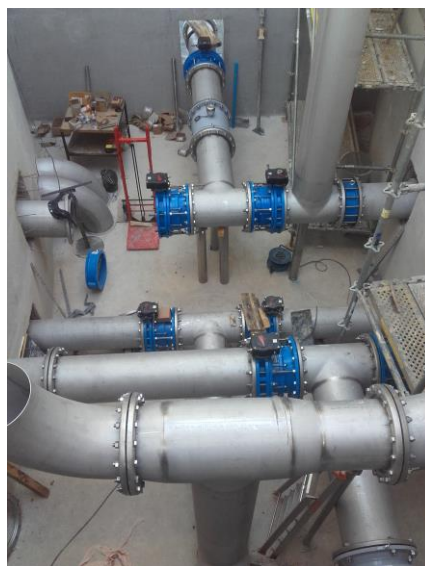
Chambre des vannes
