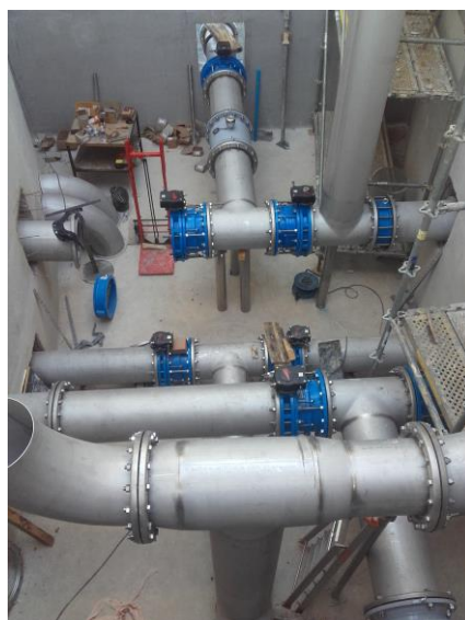
Chambre des vannes
